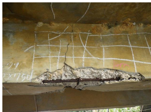
図-5 橋梁の損傷事例
