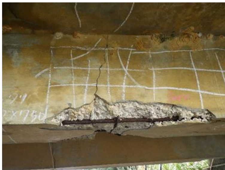
写真-1 橋梁の損傷事例（真玉橋）
