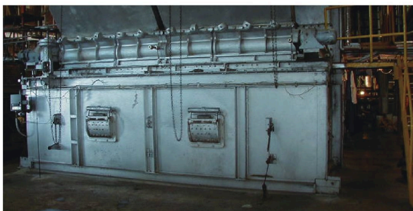
↑ 工場のボイラー
